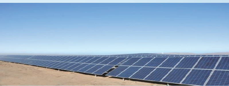
内蒙古额济纳旗30MWp并网光伏发电站
