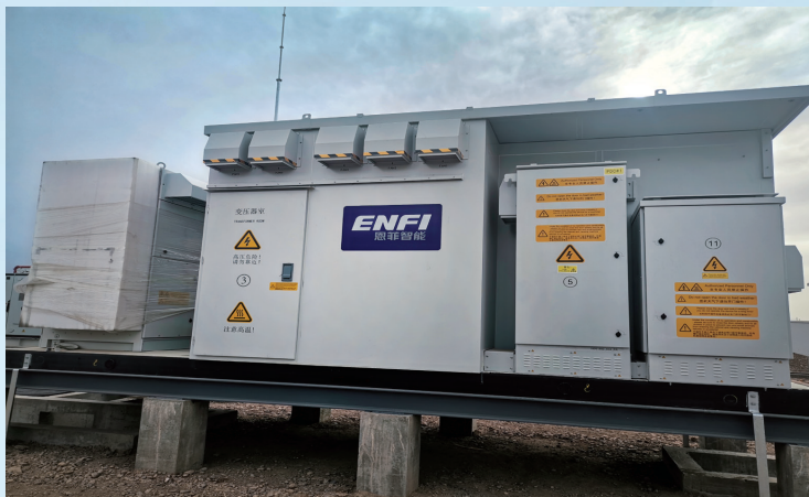
中卫一光伏电站2MWh(一期)智慧储能电站
