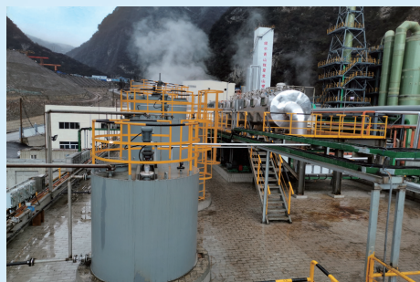
汉源比利弗含锌废渣综合回收污水深度 处理工程
