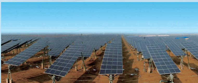
光伏发电项目
