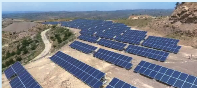
偏关县800kWp村级光伏扶贫电站
