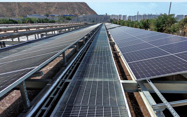
兰州雁儿湾污水厂分布式光伏电站
