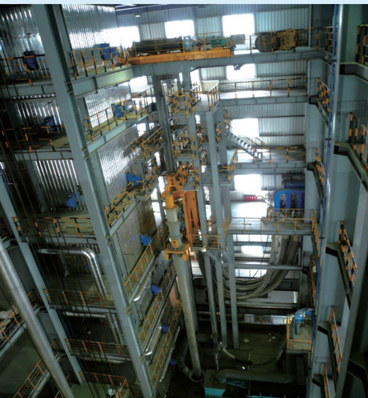
金川集团有限公司富氧顶吹镍熔炼—大型三通道式余热 锅炉工程总承包项目
