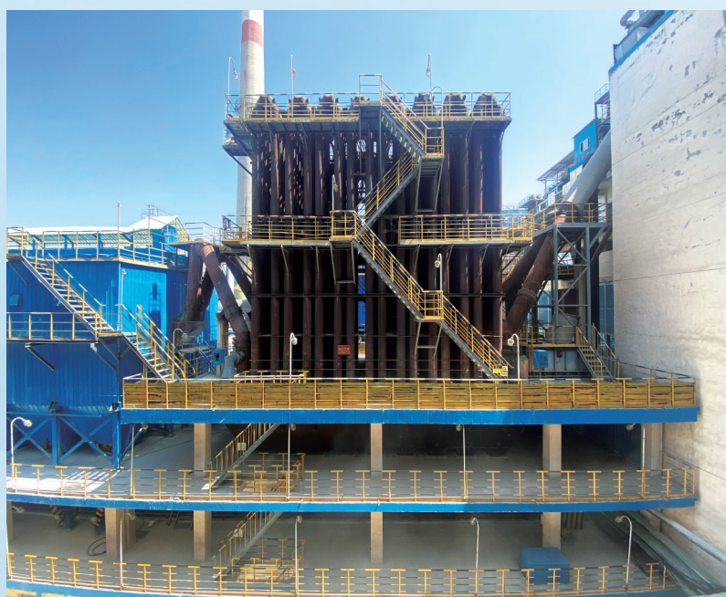
山东恒邦冶炼股份有限公司厂区余热回收利用项目
