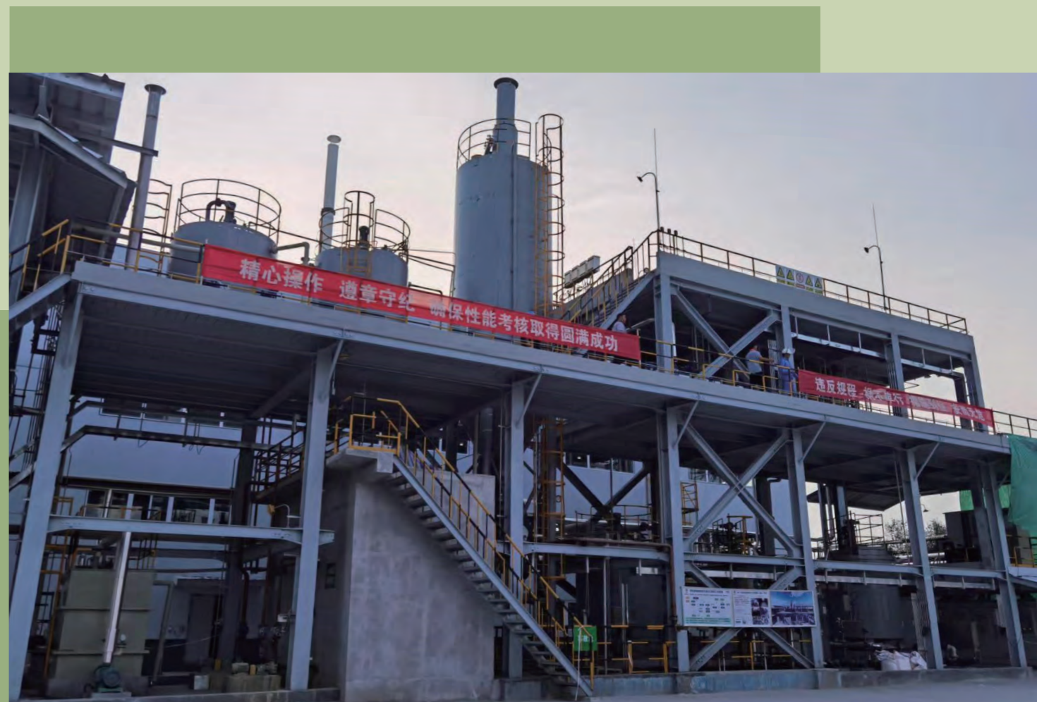
■ 陕煤石墨烯工业化示范污水处理工程
