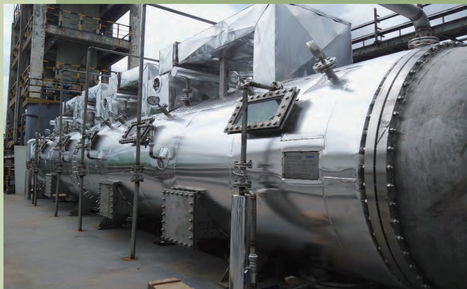
■ 云南驰宏150m 3 /d氨氮废水处理技改工程
