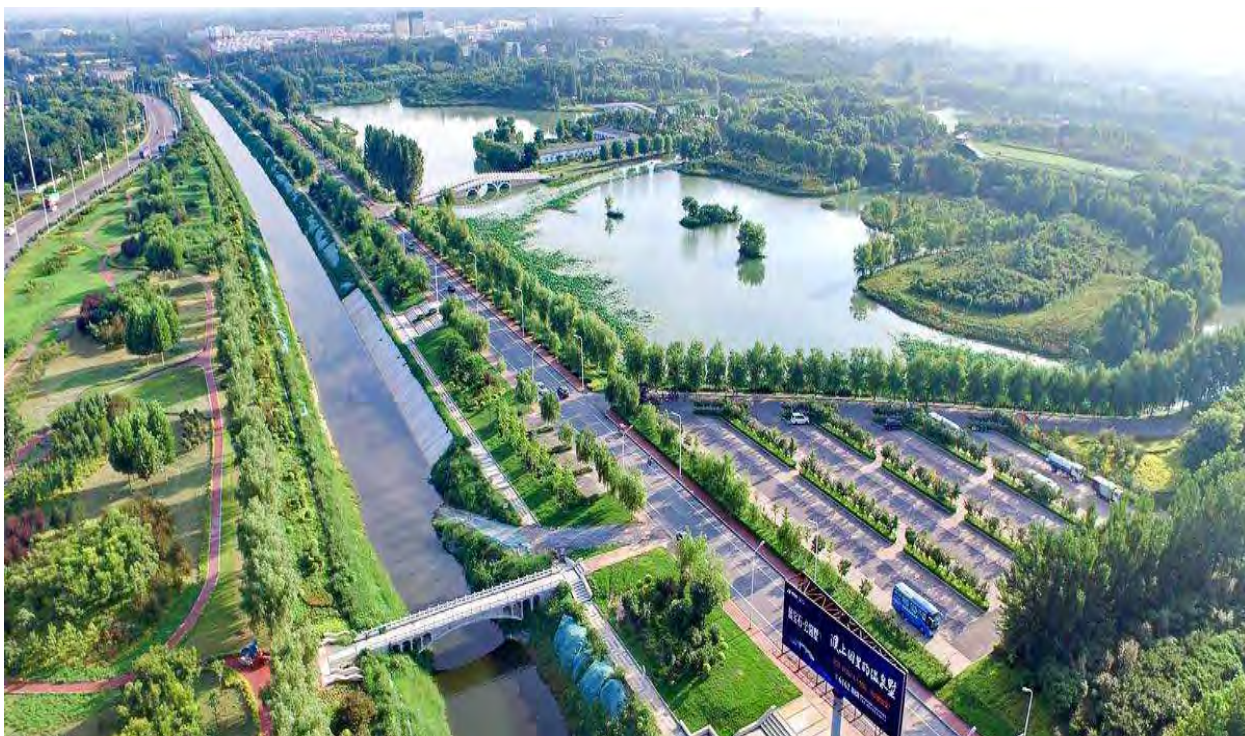
★ 雄县雄州镇古庄头村、马蹄湾村、南马庄村、十里铺村农村污水治理及淀边村岸带整治工程EPC总承包 新建污水处理总规模860m 3 /d，新建集中污泥处理站1座，新建小型污水提升泵井8座，新铺设DN300截污干管10.6km。
